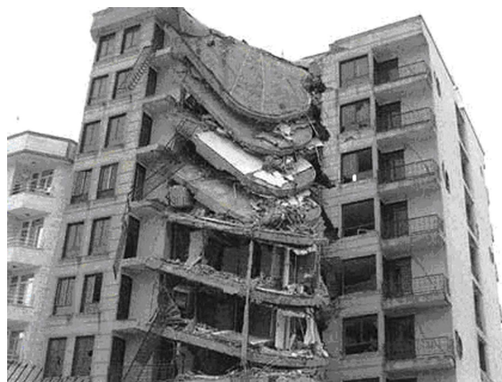
شکل ۱. فروریزش ساختمان ۷ طبقه‌ی سعادت‌آباد تهران (۱۳۸۷). [۴]
