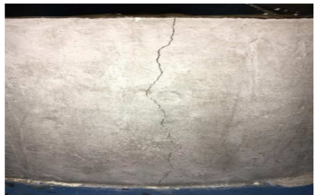
شکل ۶. نمونه‌یی از ترک اندازه‌گیری شده.
