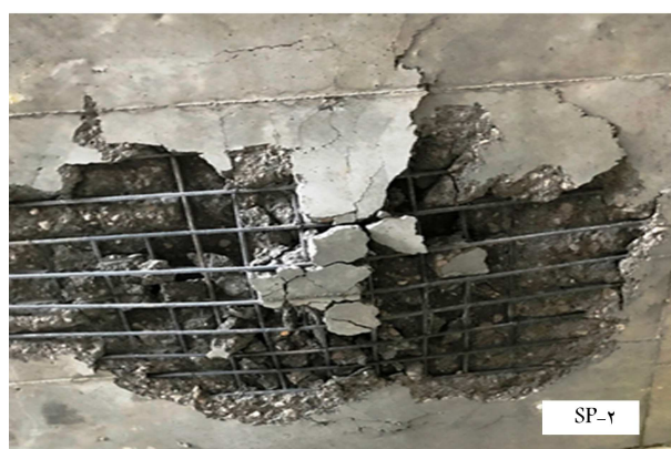
شکل ۱۲. مقایسه‌ی آسیب بتن در مخروط پانچینگ در نمونه‌های ۱ - SP و ۲ - SP در ناحیه‌ی کششی.
