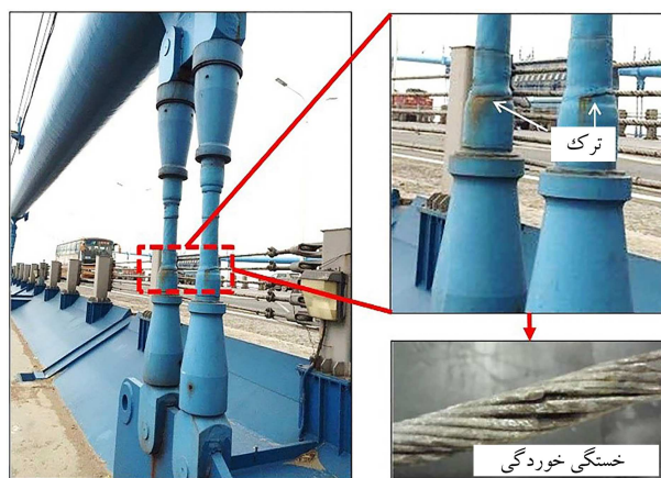
شکل ۱. نمونه‌ی از خرابی آویز پل. [۱]
