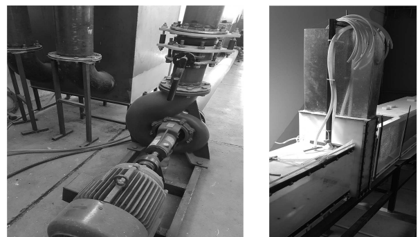
شکل ۴. نمای قسمت‌های دریچه‌ی کنترل به همراه هاوزینگ دریچه (شکل راست) و مجموعه‌ی الکتروموتور آسنکرون جفت شده به شفت دورانی پمپ‌گریز از مرکز و تجهیزات جانبی آن (شکل چپ).
